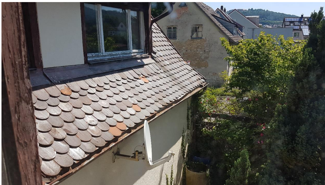
Abbildung 14: Sicht von West nach Ost aus einem Fenster im Obergeschoss. Die Dachziegel scheinen flach anzuliegen. Hinweise auf Vogelbruten (z.B. unter den Ziegeln) wurden nicht festgestellt.
