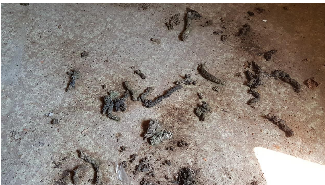
Abbildung 16: Auf dem gesamten Dachboden befinden sich zahlreiche alte Kotpuren. Dabei handelt es sich wahrscheinlich um einen Steinmarder ( Martes foina ). Frische Kotpuren wurden nicht festgestellt.
