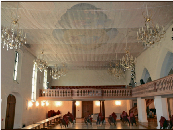
Abb. 1: Schutznetz unter der Stuckdecke.
