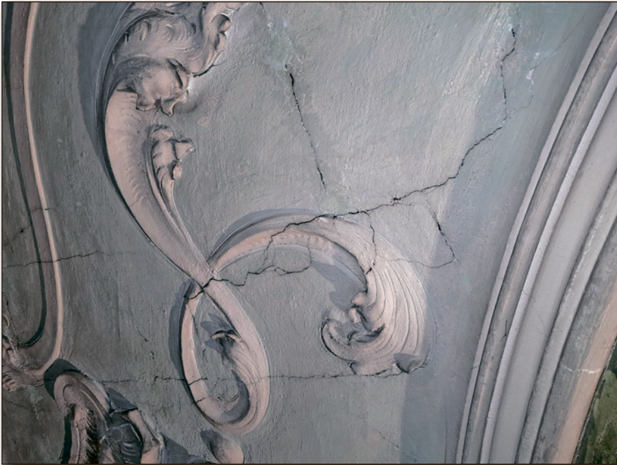
Abb. 6: Rissbild im Putz- und Stuckbereich der barocken Saaldecke.
