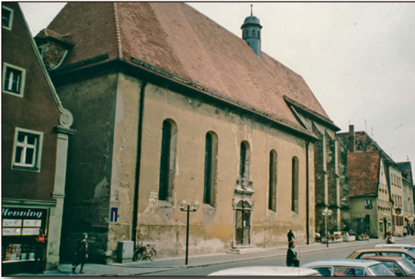
Abb. 2: Ansicht der Kirche mit der sichtbar renovierungsbedürftigen Fassade und ihrem rot-braunen Anstrich, 1978.
